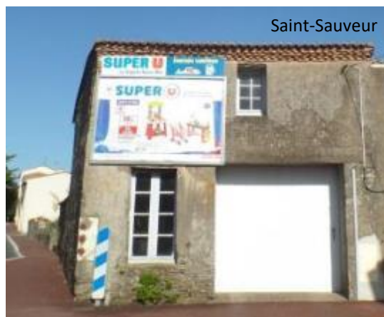
Publicité apposée sur un mur ayant des ouvertures d'une surface unitaire supérieure à 0,5m 2
